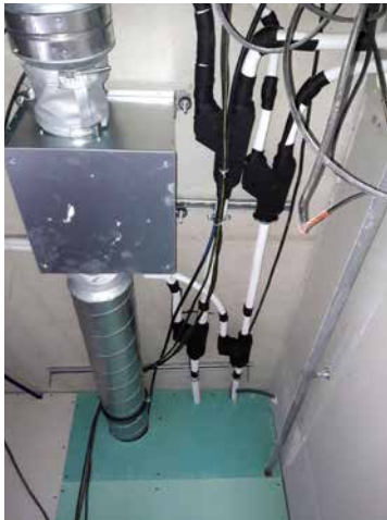
Chemin de câbles et réseaux de distribution installés avant la confection des plafonds suspendus.
