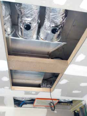
La maintenance du système de climatisation réversible implique l'accès au plenum du secteur d'accueil. Réalisée sur mesure, une trappe de grande dimension intègre un point d'éclairage.
