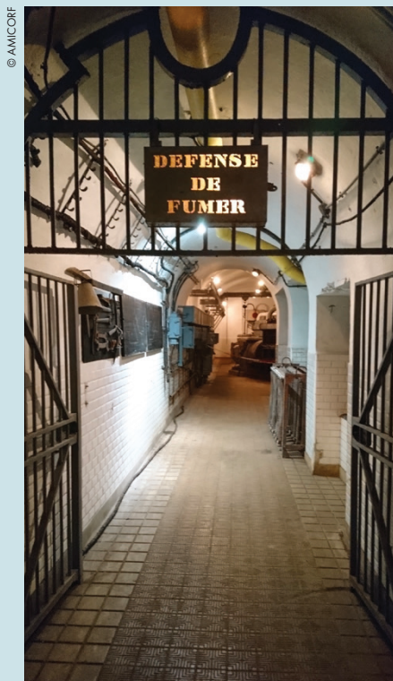
2. Centrale électrique souterraine avec 2 moteurs Renault de 77 CV.
